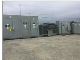
Sectionneur extérieur (S&C) reconditionné 25KV, 1 cellule de mesure Hydro-Québec 25 KV (1) Sectionneur extérieur (S&C) reconditionné 25KV et 1 transformateur triphasé Padmount 750 KVA reconditionné P.S.D.
